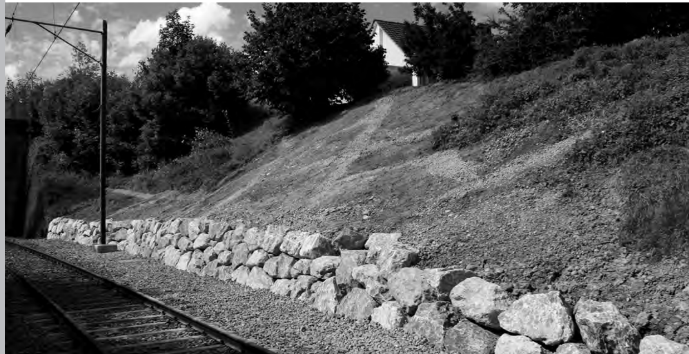
Der frisch sanierte Rutschhang im Morgenwies: Das Wiesenbord gefährdet die Fahrbahn auch bei starken Niederschlägen nicht mehr.
