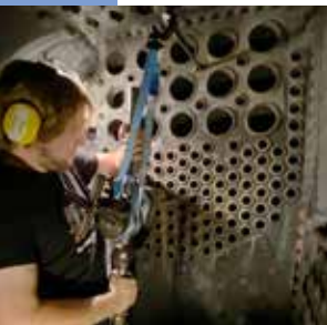
Altes Handwerk: Marco Johann beim Nachwalzen der Siederohre im Kessel der Lok 9.
